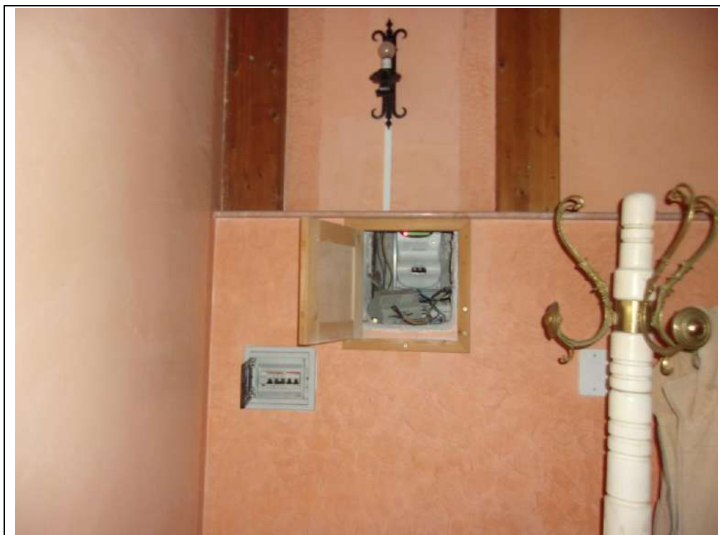
linea accesso impianto elettrico
