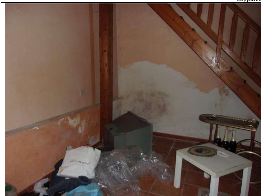
tracce di umidità piano terra
