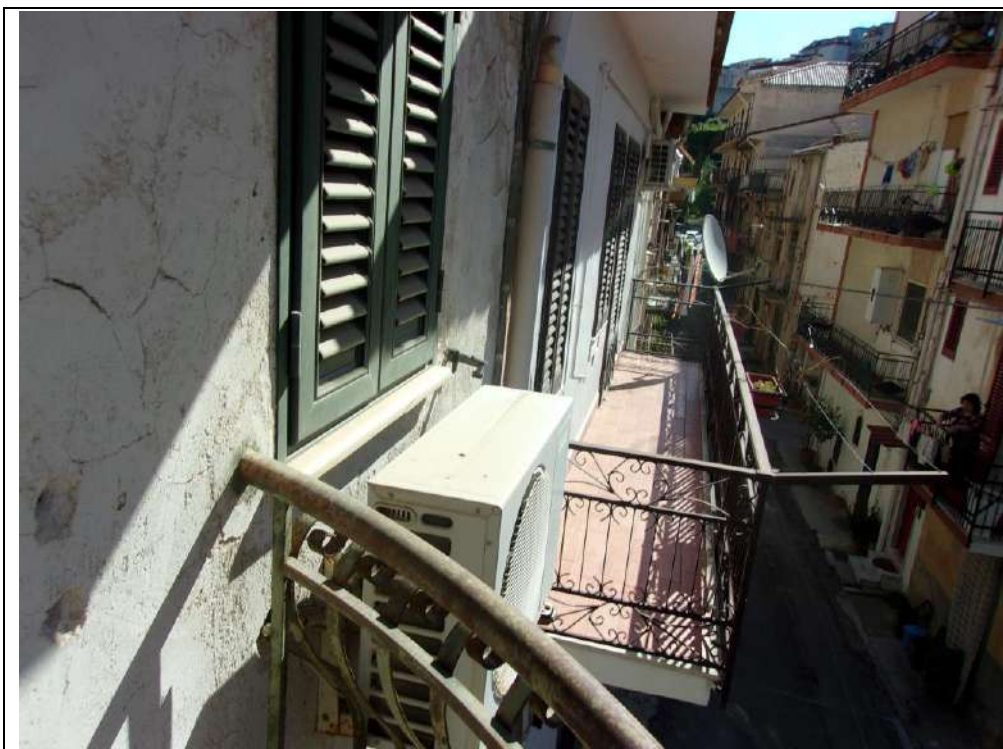
impianto esterno climatizzatore
