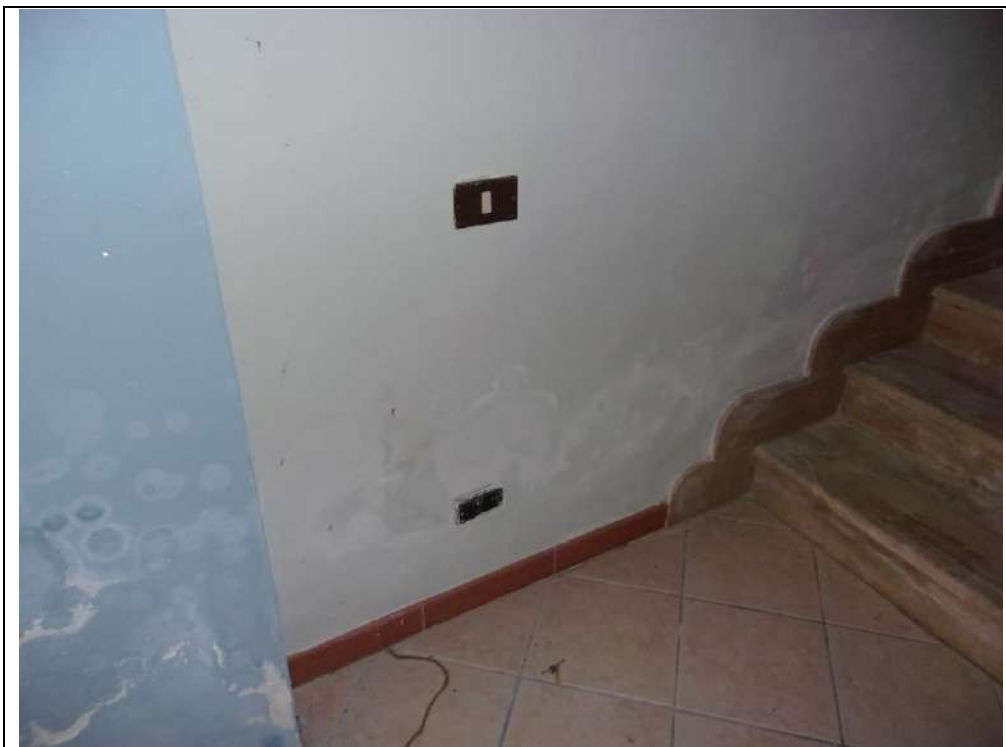
infiltrazioni da perdita cisterna ed impianto elettrico
