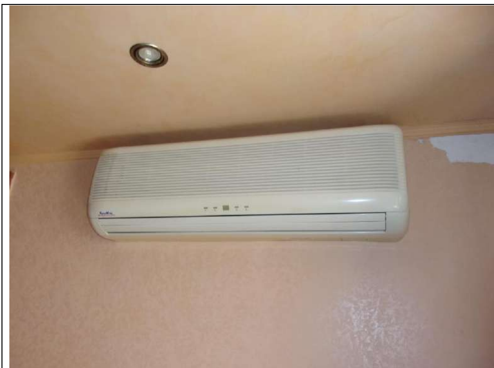
impianto interno climatizzatore
